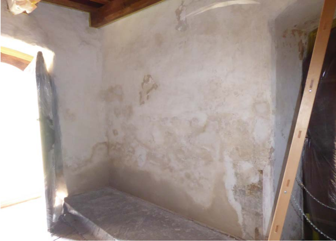
Bild 5: Referenzbereich Wandfläche Südwest Eingang nach Abschluss der Putzergänzungsarbeiten. Der Anstrich erfolgte nach Austrocknung der neu aufgetragenen Putzflanken.
