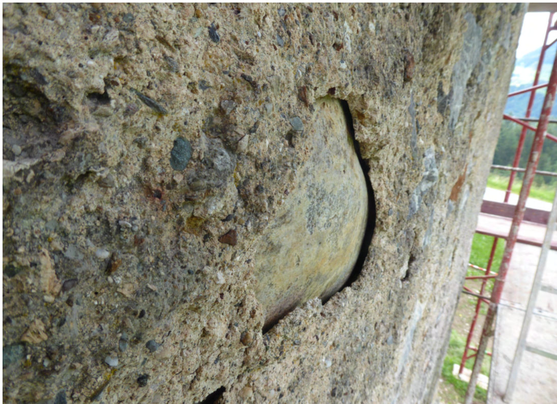
Bild 23 unten Detailansicht Turmseite Nord: Schollenförmiges Ablösen der Putzlage vom Putzträger(Steinmauerwerk).
