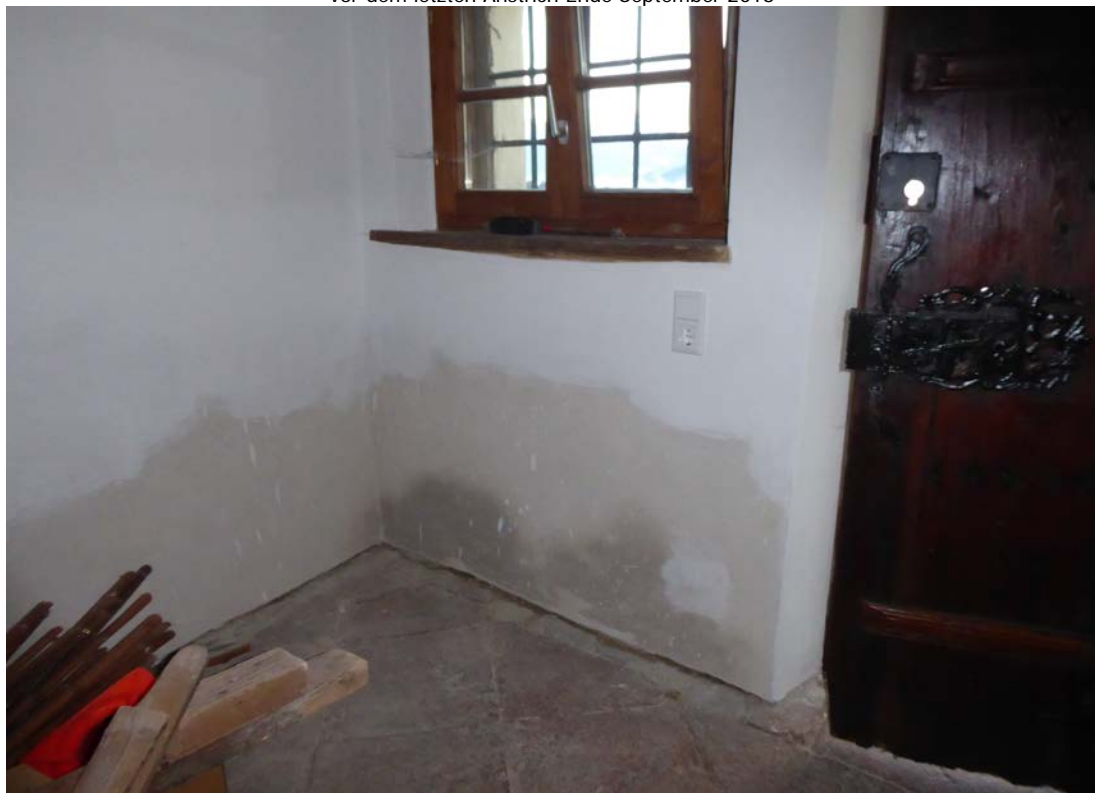
Bild 11 unten Wandfläche Südwest: Nach der ersten Ausmahlung mit Kalktünche erfolgte eine weitere Austrocknungsphase vor dem letzten Anstrich Ende September 2018
