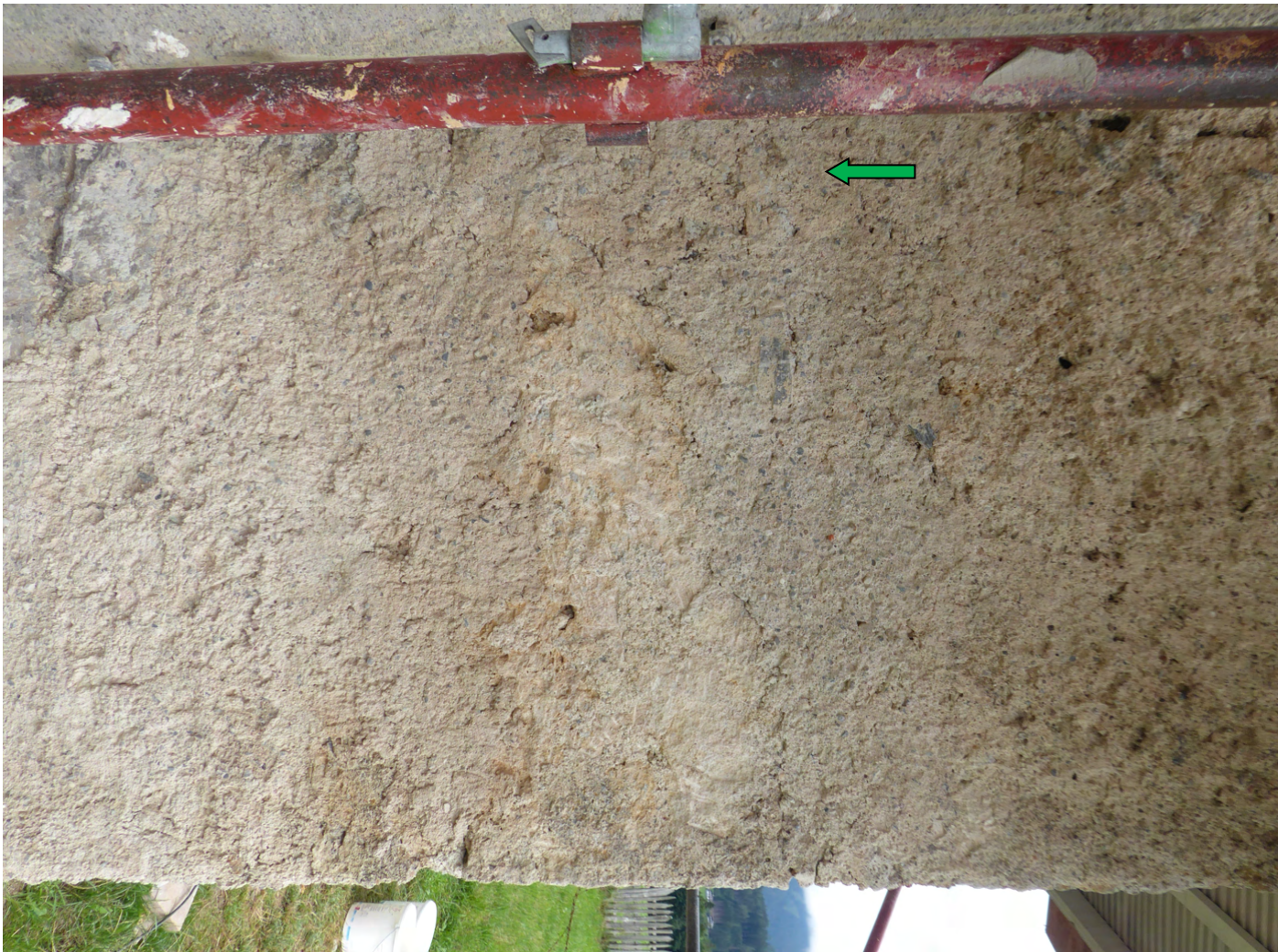
Bild 13: Angelegte Putzmusterfläche. Im oberen Bildbereich mit orig. Bestand(Pfeil grün) und angelegtem Putzmuster(Pfeil rot) mit gleicher Textur und Farbgebung in reinem Kalkmörtel.
